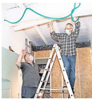
Kay Högel (li.) und Hans-Jürgen Clasen schrauben einen Kabelbaum an die Decke ihres Bootshauses. Sie erneuern beim Sommereinsatz die Elektrik auf dem Vereinsgelände des Kanu-Sport-Clubs.
